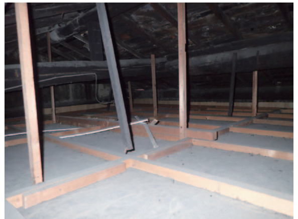
天井板は石膏ボードを屋根裏から吊り下げていた。
