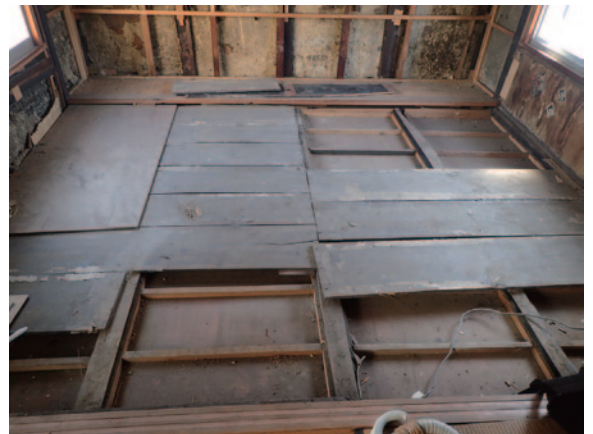
5月7日 床板をすべて剥がし、構造をチェック。一部に沈降が見られ、両サイドを角材で補強する。
